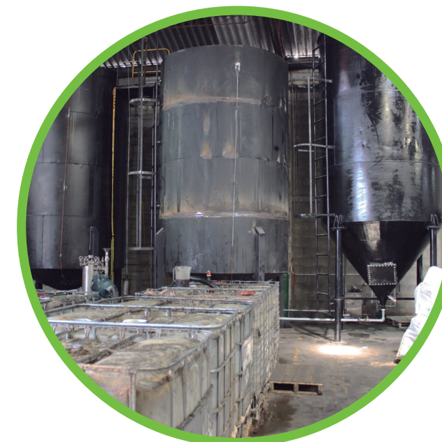
Tanques de recepción de grasas y aceite
